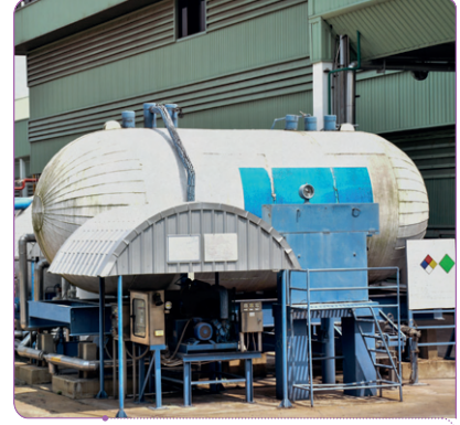
Görsel 2.22: \text{CO}_2 zenginleştirme işleminde kullanılan tank
